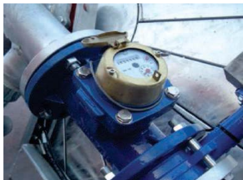
سیستم کنترل حجمی آب مصرفی (کنتور حجمی)
