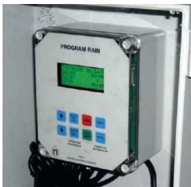
سیستم قابل برنامه ریزی (PLC)
